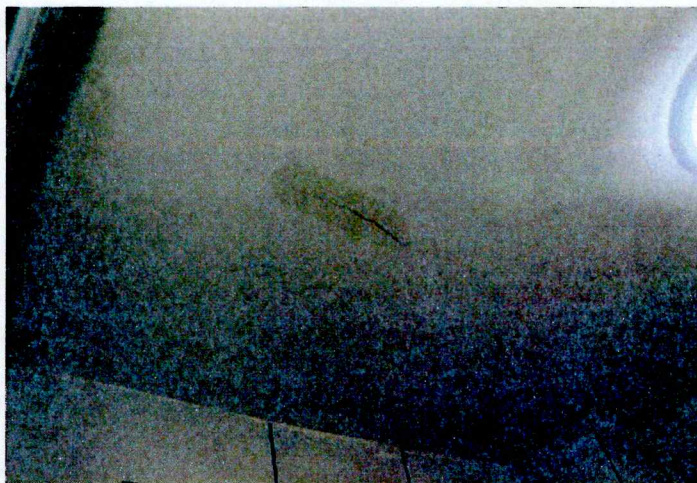
图 15 内抹灰层裂缝有渗水痕迹
